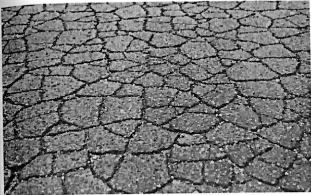
รอยแตกแบบผิวจระเข้ (Alligator crack)
